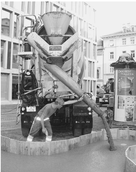
Das Brunnenfundament wird mit einem selbst nivellierenden Beton in wenigen Minuten ausgegossen
