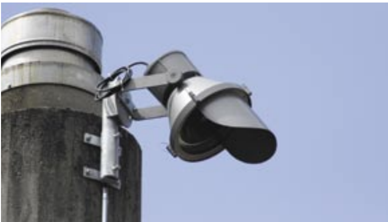
Keine ideale Ausrichtung, aber durch die angebrachte Abschirmung akzeptabel.
