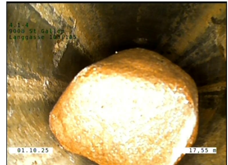
Abbruch der Inspektion, Hindernis, Grosser Stein
