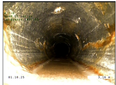
Anfang (2): Pos: 6; Harte Ablagerungen, Höhe = 3%
