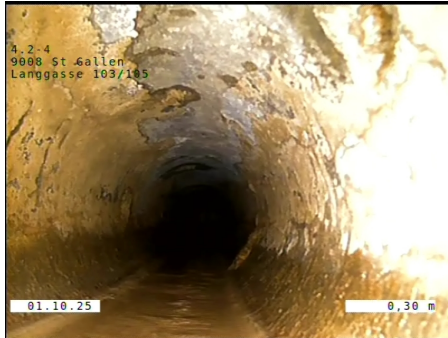
Anfang (4): Pos: 6; Harte Ablagerungen, Höhe = 3%
