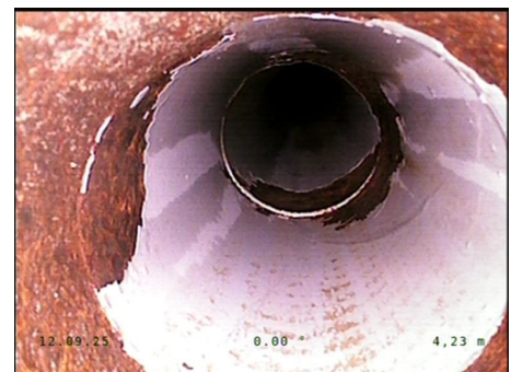
Abbruch der Inspektion, Fallstrang erreicht
