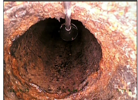
Abbruch der Inspektion, Fallstrang erreicht
