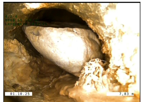
Abbruch der Inspektion, Hindernis, Kein weiter kommen Kamera Stein? Leitungsbruch?
