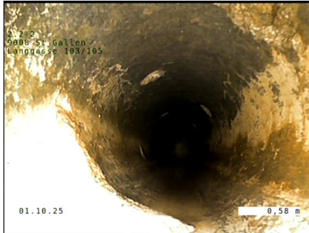
Pos: 6 - 8; Harte Ablagerungen, Höhe = 3%
