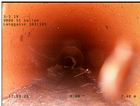
Anfang (1): Pos: 5 - 7; Harte Ablagerungen, Höhe = 3%
