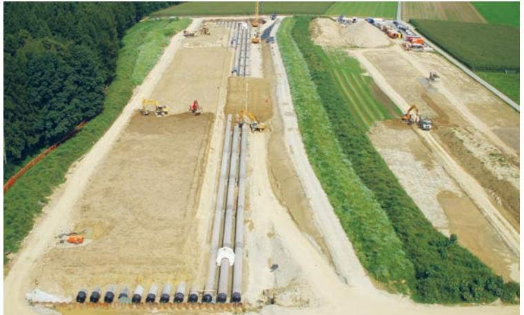
Bild: Röhrenspeicher in Etziken (Quelle: Jauslin+Stebler Ingenieure AG)
